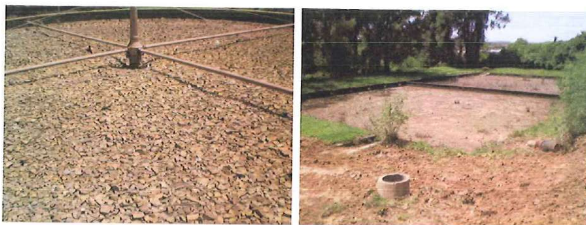
Ilustração 26 - Filtro biológico e leito de secagem da ETE
