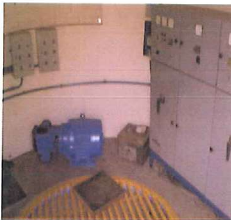
Ilustração 8: Estação de recalque de água bruta
