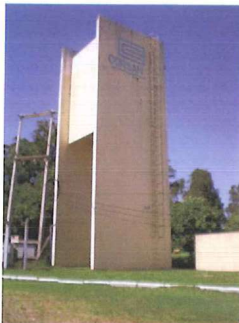
Ilustração 15: R3 da ETA - lavagem dos filtros
